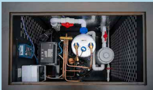
Kylkompressor/värmepump håller vattentemperaturen komfortabel.
